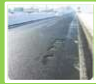
路面の穴ぼこ・段差
