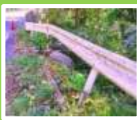
ガードレール・ 標識等の損傷
