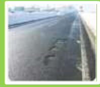
路面の穴ぼこ・段差
