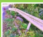
ガードレール・ 標識等の損傷
