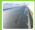
路面の穴ぼこ・段差
